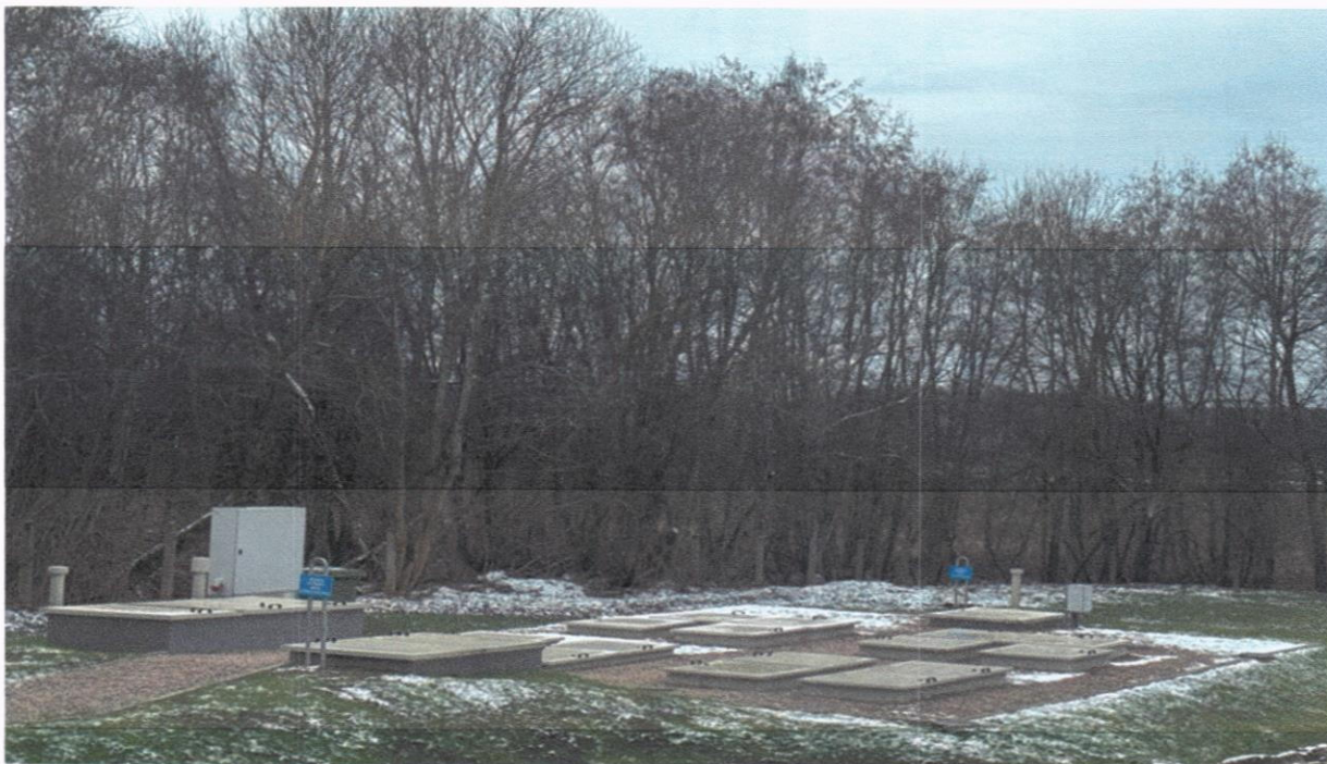
1.2.1 pav. UAB „Ukmergės vandenys“ Pabaisko mst. biologiniai nuotekų valymo įrenginiai
